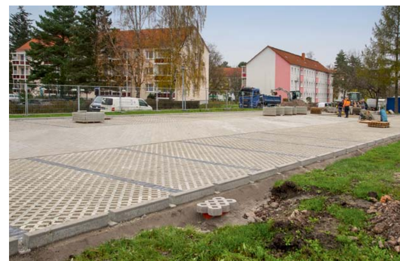
In Gräfenroda soll die neue Anlage mit 34 Stellplätzen bis zum Jahreswechsel fertiggestellt werden.
