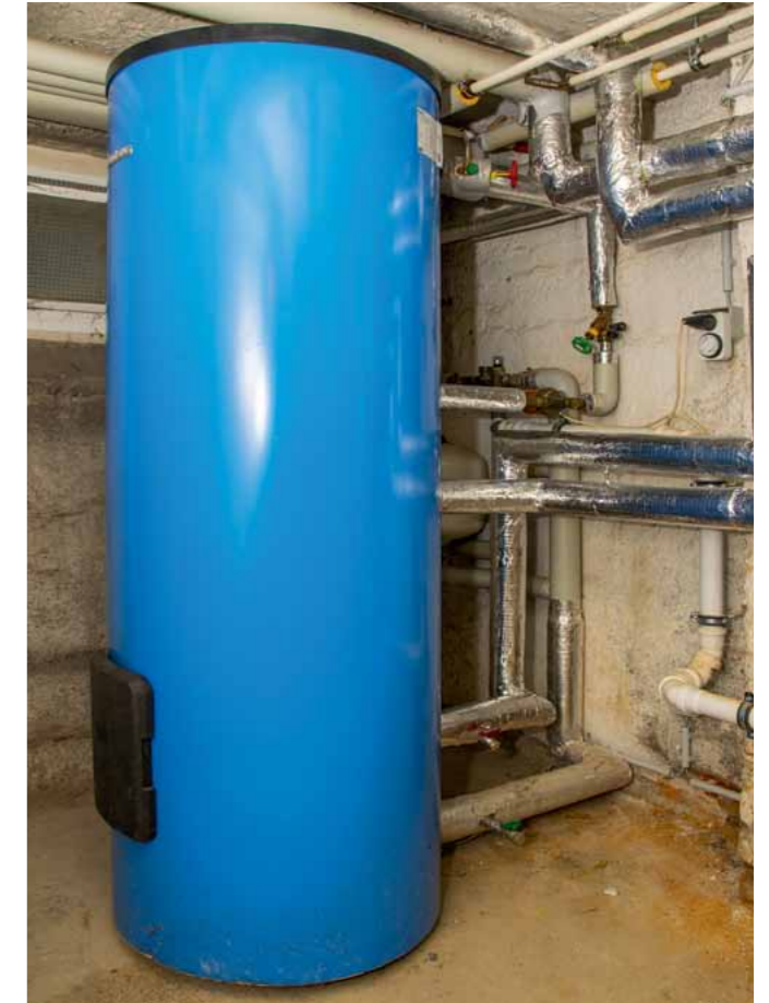
Im Nebenraum wird Warmwasser zwischengespeichert, um eine sichere und zügige Versorgung mit Warmwasser in den Wohnungen sicherzustellen.
