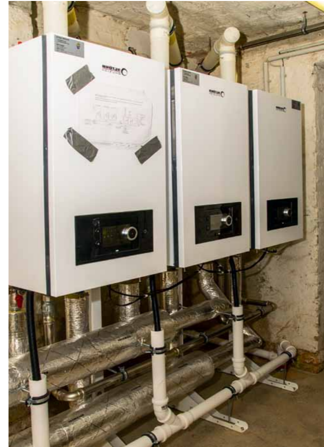
Die Wärmeversorgung übernehmen drei neue Brennwertthermen. Dabei wurde der bisherige Schornstein saniert, um so die Abluft der drei Thermen nach draußen zu führen.
