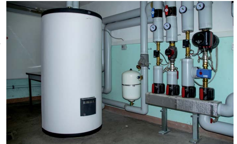
In den drei Nachbargebäuden wurden jeweils eine Unterverteilung und ein großer Wasserspeicher installiert.
