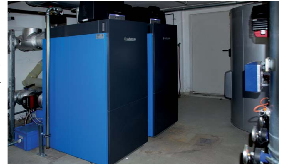
Die zentrale Heizstation ist im Keller eines Gebäudes untergebracht und versorgt insgesamt 48 Wohnungen mit Wärme und Warmwasser.
