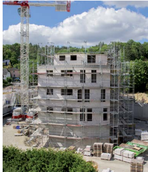
Im Haus 2 begann im Juli die Montage der Fenster und der Innenausbau.
