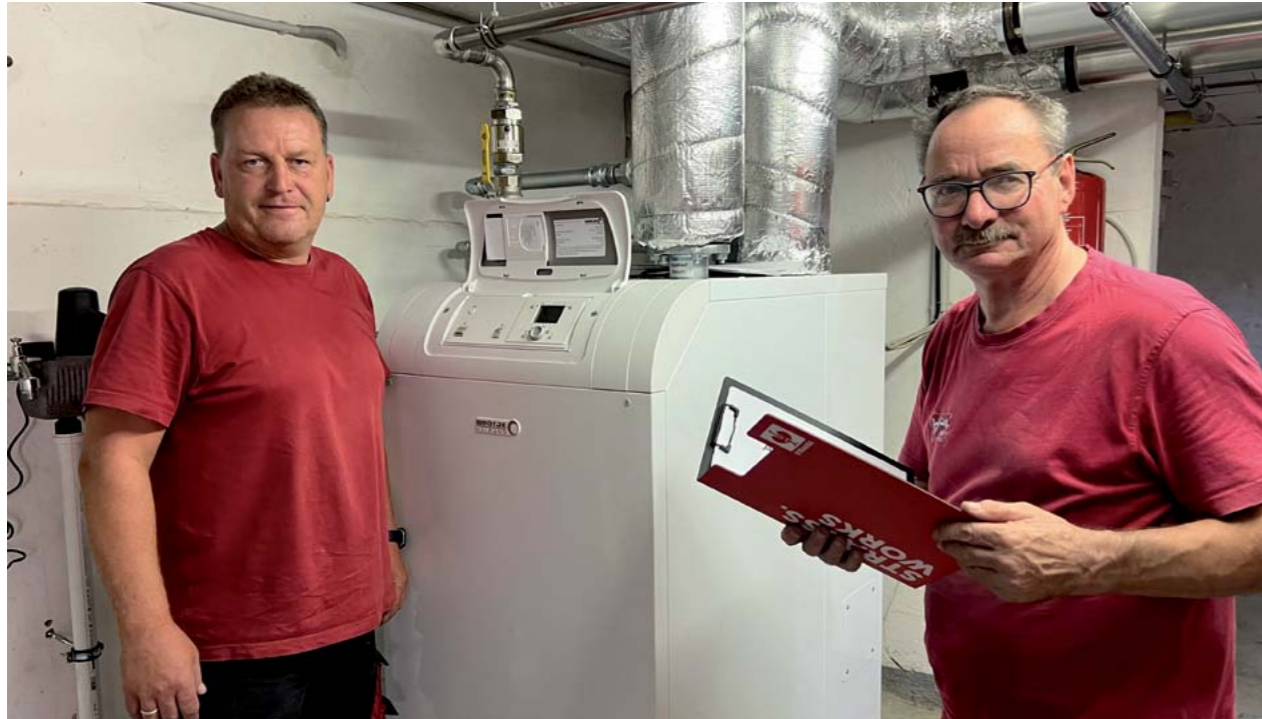
Im Rahmen der monatlichen Kontroll- und Wartungsgänge durch die beiden VGS-Hauswarte Hendrik Stötzer (links) und Peter Hahn wird u. a. auch die Anlage in Gräfenroda regelmäßig überprüft.
