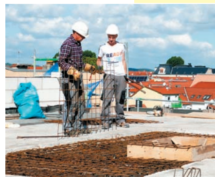
VGI und WBG Arnstadt kooperierten auf der Baustelle „An der Weiße“ in Arnstadt. Eine tolle und gute Zusammenarbeit.
