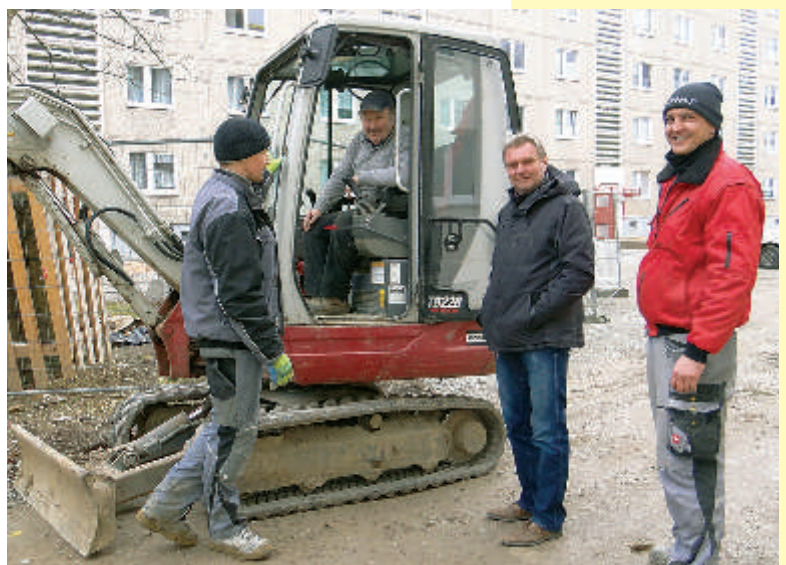
Kurze Baubesprechung über die in Arbeit befindliche Entwässerung und Drainage im Wohnumfeld. Im Bild von links nach rechts: Marco Plaul, im Kleinbagger Andy Köhler, Volkmar Sendler und Christian Zupp.
