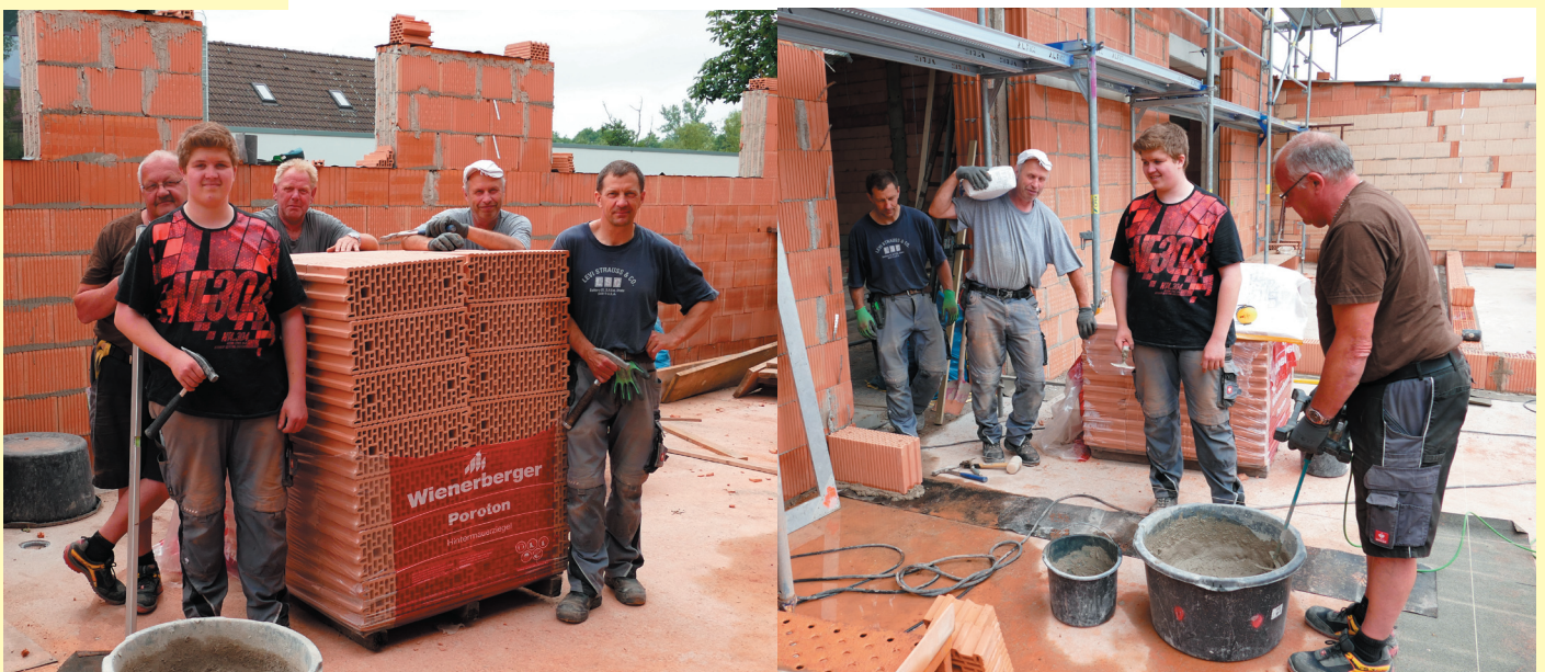
Michael Bock, Azubi Fabian Bielek, dahinter Renald Jäger, Hanko Heinze und Ralf Fabricius (von links nach rechts) gehören zum Bauteam, welche die neue Sporthalle der Europaschule Marlishausen errichten. Fabian Bielek ist im ersten Lehrjahr. „Ja, mir macht der Bau schon Spaß,“ sagt er - „...und das Team ist schwer in Ordnung. Da lernt man wenigsten was“.
