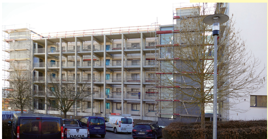
Beendet wurden die Arbeiten der VGI in der Paganinistraße. Hier wurden zwei Wohnblöcke getrennt, ein Aufzug, Treppenhaus und ein Laubengang gebaut. Ein spezieller Dachanbau auf dem Wohnhaus wurde ebenfalls von der VGI aufgesetzt.
