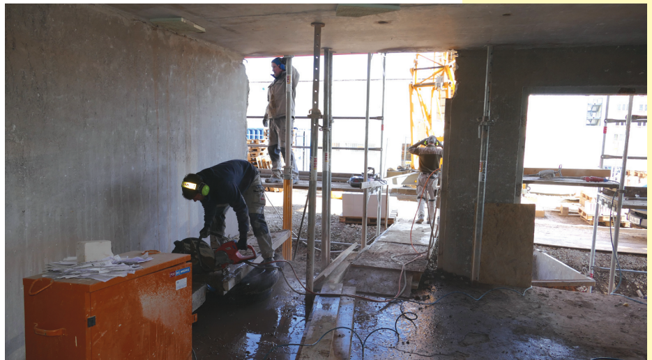
Währenddessen schon die ersten Türen zugemauert und Zwischenwände eingezogen werden, ist eine Partnerfirma dabei, mit Spezialwerkzeugen Betonwände zu zerschneiden. Nicht nur eine schwierige und schwere Arbeit, sondern auch eine, die viel Lärm verursacht. In unmittelbarer Nähe ist der Lärm nur mit Ohrenschutz zu ertragen.
