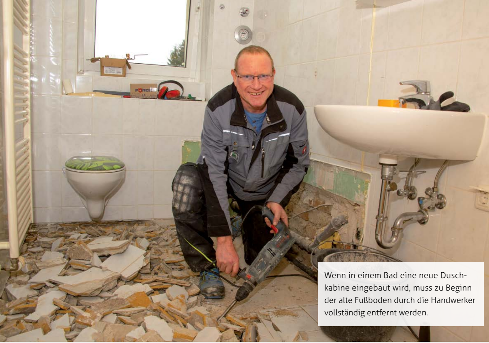
Bei einer Strangsanierung werden die Leitungsstränge durch die Handwerker unserer Tochterunternehmen im Zuge eines gut organisierten Bauprojektes erneuert. Dabei wird der Wohnraum von der Baustelle durch stabile Baufolien getrennt, damit sich der während der Arbeiten entstandene Staub nicht in der Wohnung ausbreitet.
